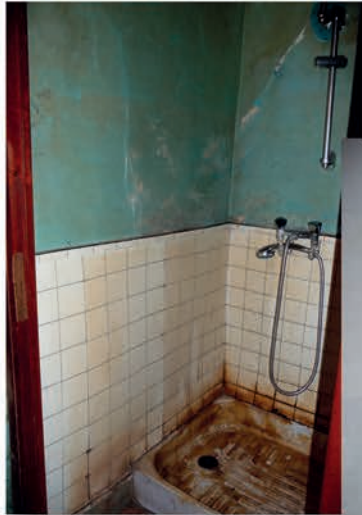
Logement insalubre Labastide de Sérrou avant rénovation
