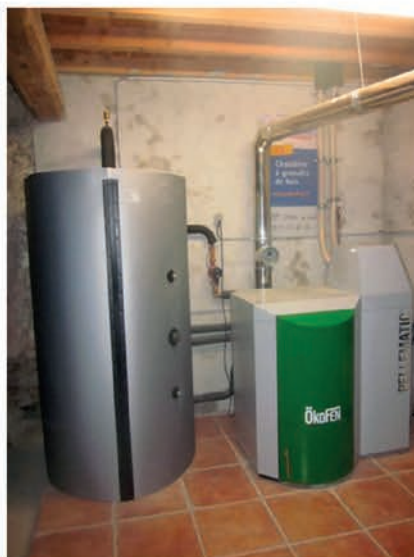
Chaudières à granulés bois à Montégut Plantaurel
